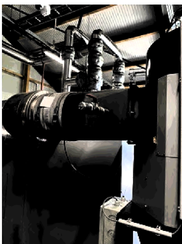
12-07-2022- sensor rookgasafvoer ketel 1
