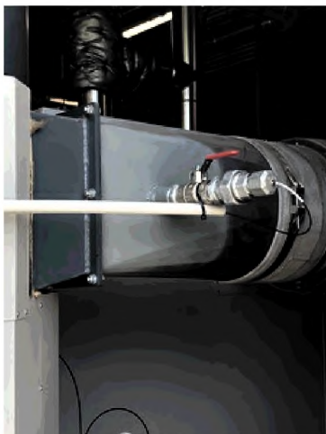
12-07-2022-close up van sensor rookgasafvoer ketel 2
